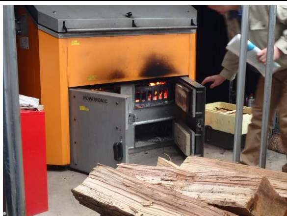
（薪ボイラー内部）
