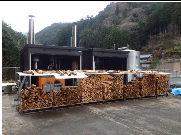
（薪ボイラー2基）
