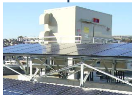
事業所用蓄電池
