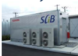
東京電力網島変電所に設置した大規模蓄電池
